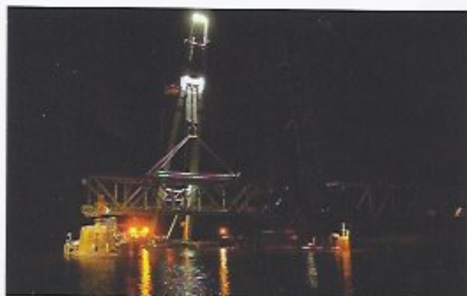
WEENER: Die Friesen-Eisenbahnbrücke wird für den Transfer nicht nur hochgeklappt, sondern auch teilweise demontiert.
